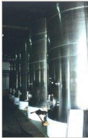
Tanques de aço inox
